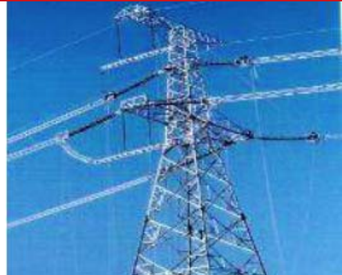
750KV 输电铁塔
