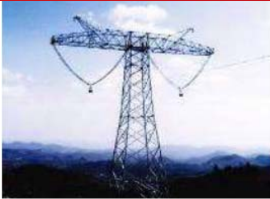
特高压输电铁塔
